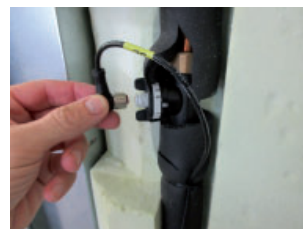
Volumenstromgeber Heizung B2
